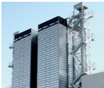
Полностью теплоизо- лированная шахта
